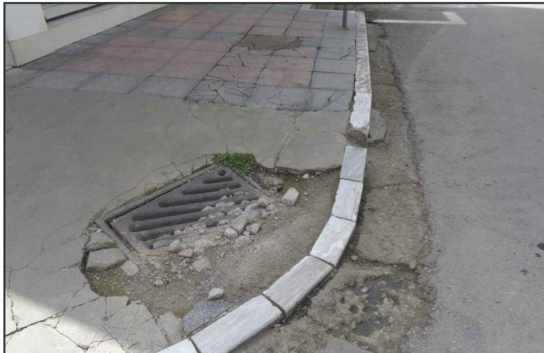
Κι άλλο κατεστραμμένο και επικίνδυνο πεζοδρόμιο στο κέντρο της Καρδίτσας!!!
