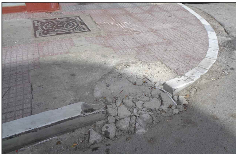
Ένα από τα πολλά πεζοδρόμια που χρήζουν άμεσης αποκατάστασης!!!
