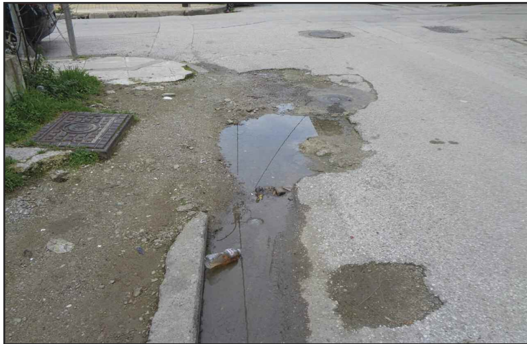
Εκτός από κατεστραμμένο, τώρα το εικονιζόμενο πεζοδρόμιο έγινε και μικρή λίμνη!!!
