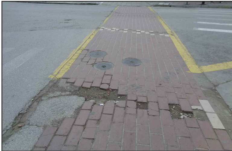
Σπασμένα πλακάκια και στον ποδηλατόδρομο που οδηγεί στο Εμπορικό κέντρο!!!
